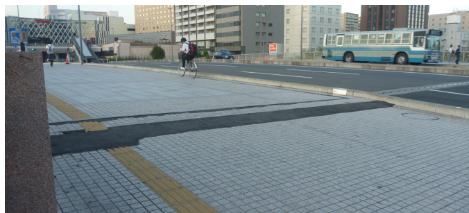
水戸駅南口駅、桜川に掛かる橋もずれが生じ、応急処置がされている
