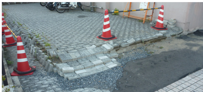
水戸駅南口交番横も地盤沈下し、舗装が凸凹になっている
